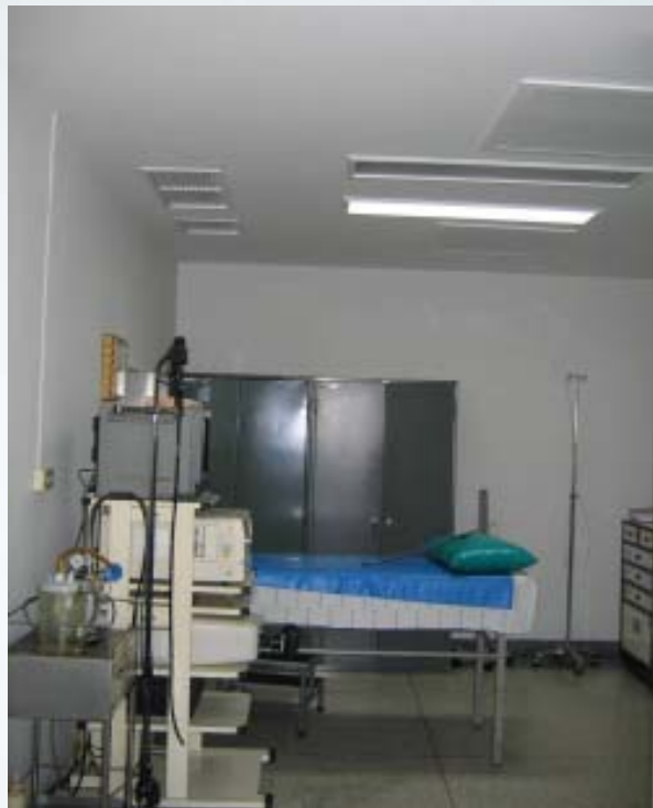
ภาพที่ 28 ห้องตรวจสอบกล้อง แสดงตำแหน่งหัวจ่ายลมและแผงรับลมกลับ
