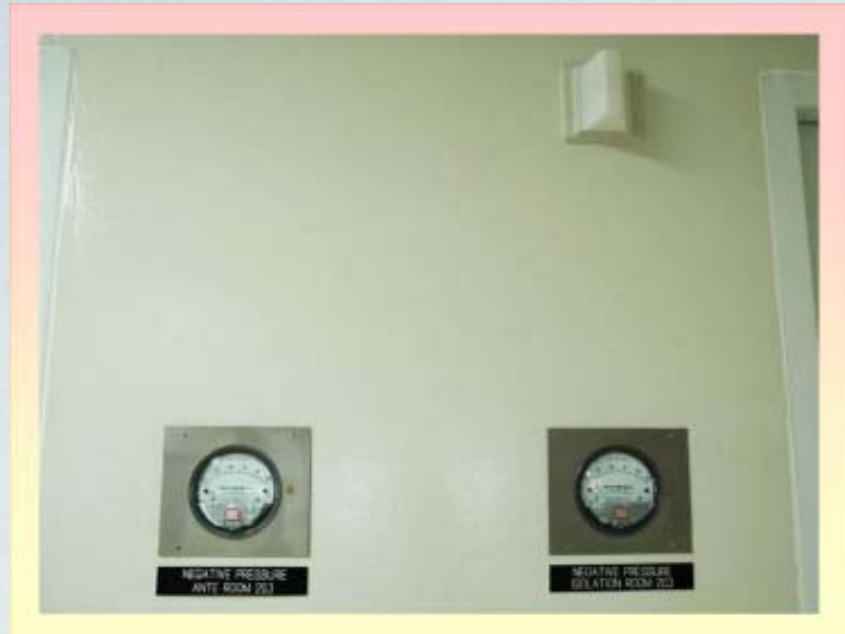
ภาพที่ 7 แสดงแผงวัดความดันอากาศสำหรับห้องผู้ป่วย และ Anteroom ติดตั้งไว้บริเวณหน้าห้อง มองเห็นได้ชัดเจนในระดับสายตา
