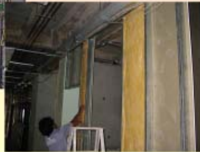
ภาพที่ 4 แสดงการก่อสร้างเพื่อจำกัดรูรั่วของห้อง AIRR
