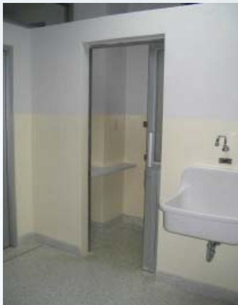
ภาพที่ 32 แสดงอ่างล้างมือ และห้องอาบน้ำในห้อง Anteroom ของห้องเพาะเชื้อวัณโรค และห้องเพาะเชื้อรา
