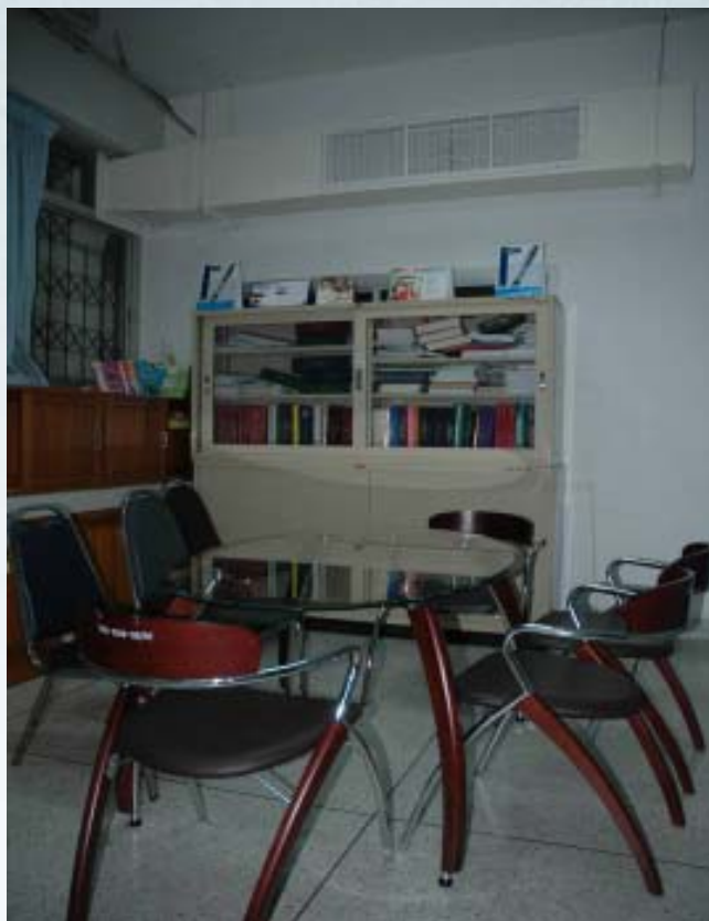
ภาพที่ 34 แสดงระบบปรับอากาศและกรองอากาศ ภายในห้องให้คำปรึกษา แก่ผู้ป่วย
