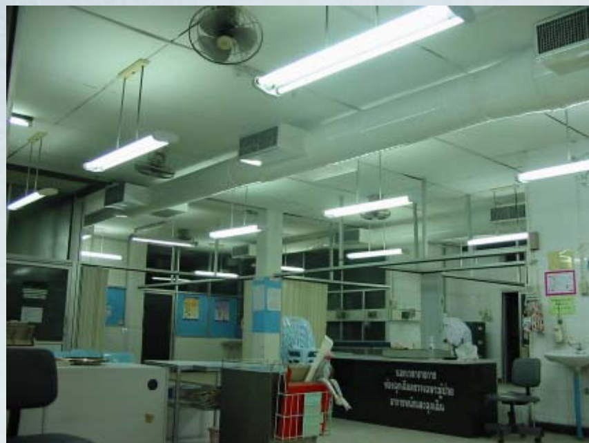
ภาพที่ 25 ห้องฉุกเฉินแสดงตำแหน่งหัวจ่ายลมที่ผ่านการกรองด้วยแผงกรองอากาศ จ่ายลมในตำแหน่งใกล้บุคลากร
